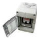
Siche- rung / FI
